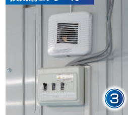
換気扇&ブレーカー
